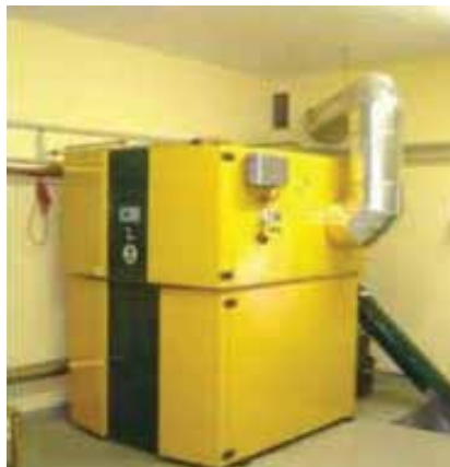
Ogrevalni sistem Holzenergie-Contracting St. Martin/W
