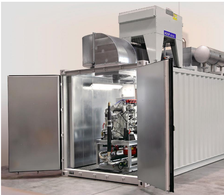
Slika 37: SPTE enota, zunanja izvedba
