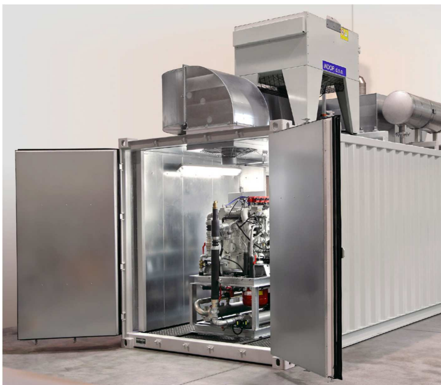
Slika 4. SPTE enota, zunanja izvedba.
